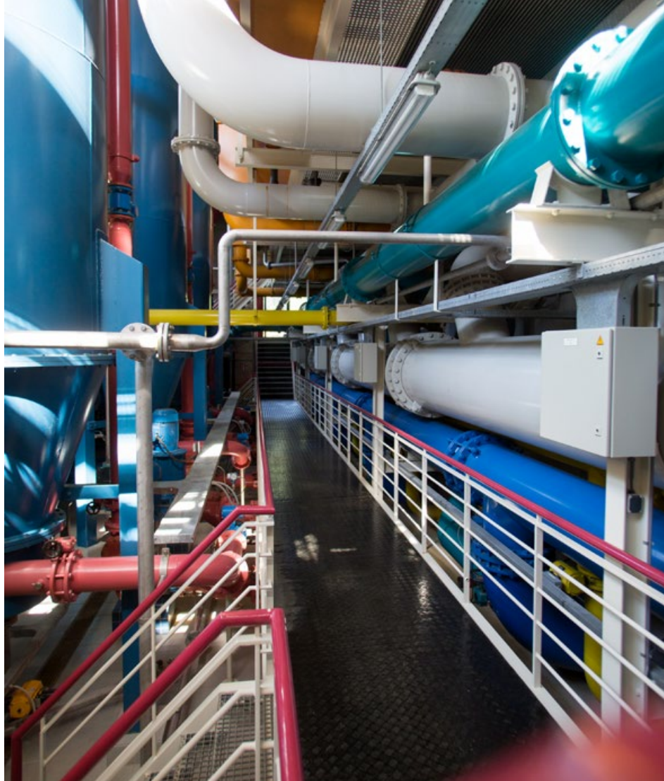
Drinkwaterproductiestation Assen van WMD.
